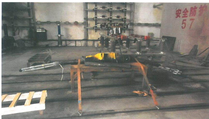
(图二：电缆中间接头防爆盒完成检测后)
